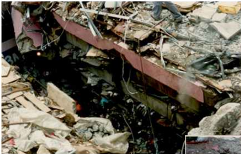
플랫 슬래브 붕괴 1-1
