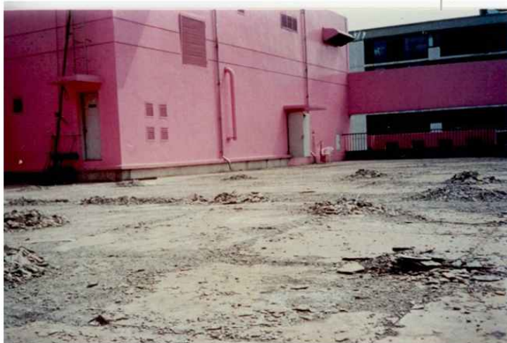
지붕층 바닥 변형 상태
