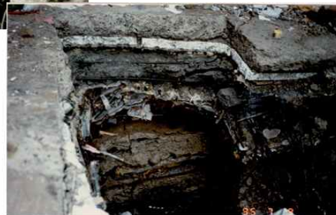
플랫 슬래브 붕괴 1-2
